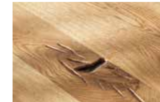
Offene Äste/Risse ausgeschliffen
